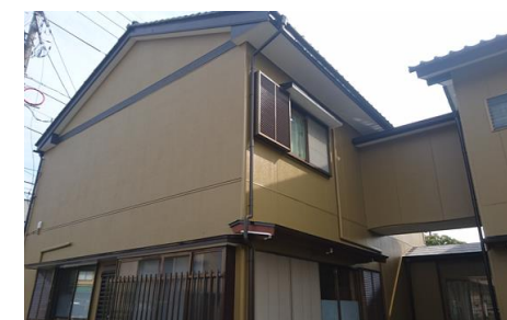
福井市U様邸。外壁の一部を張替えし、塗装しました。落ち着いた風合いです。
